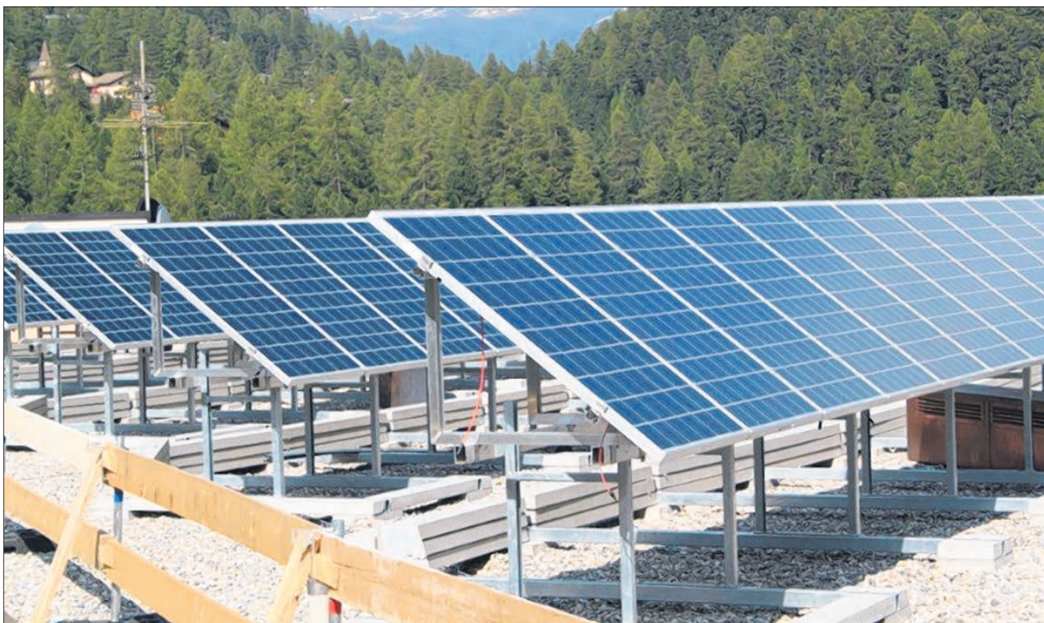
Die Solaranlage auf dem Hotel «Europa» ist die grösste seiner Art.
